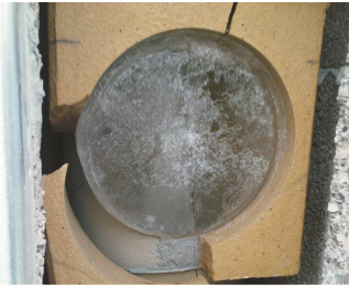
Frostschaden durch Wasserrückstau bis zur Revision, verursacht durch zugefrorenen Siphon
